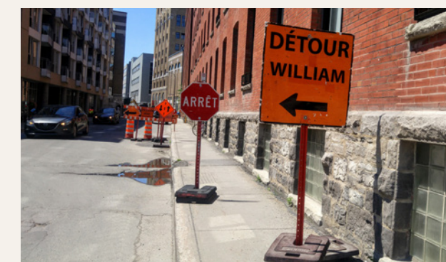
MAUVAISE GESTION DE PASSAGE DE CHANTIER
