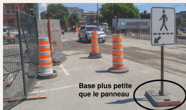
MAUVAIS EXEMPLE DE BASE DE PANNEAU
