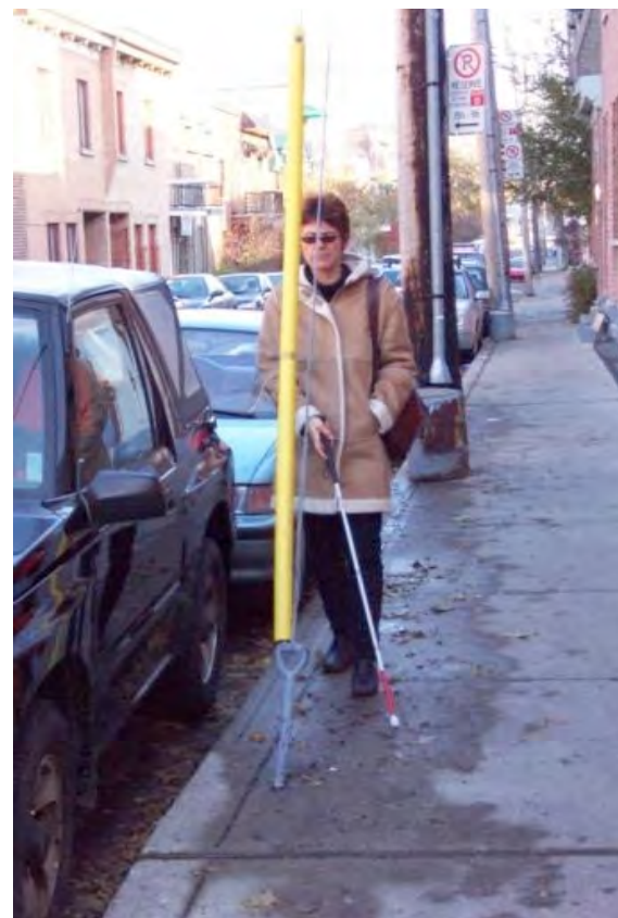
Photo 7 : Hauban oblique constituant un obstacle dangereux
