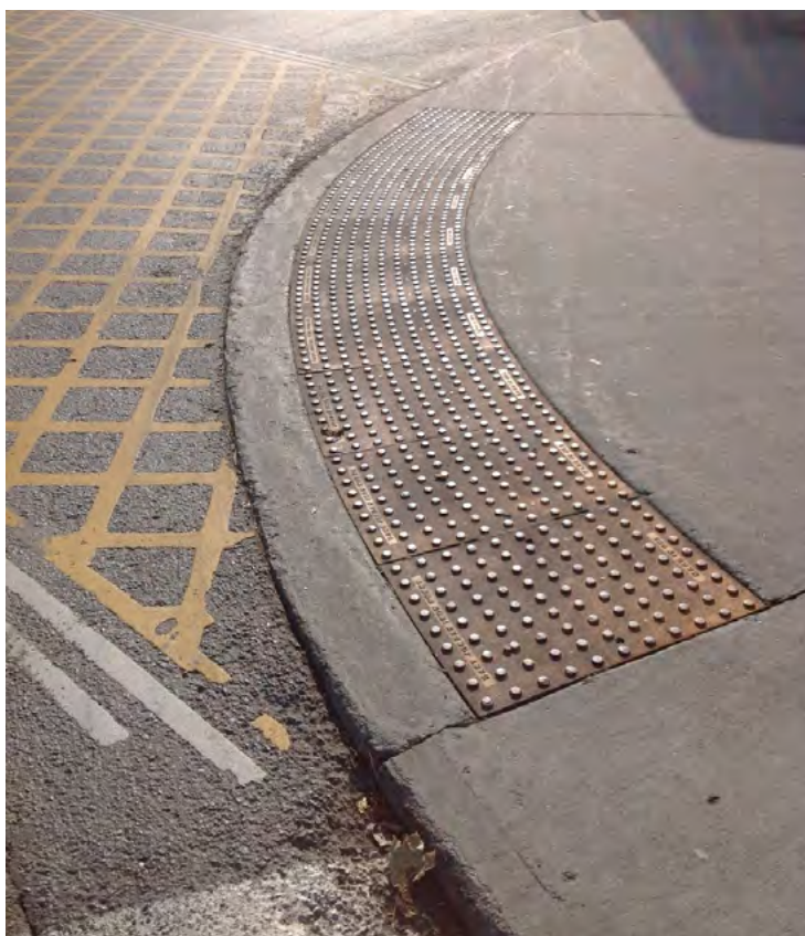
Photo 5 : Surface avertissante détectable tactilement et visuellement
