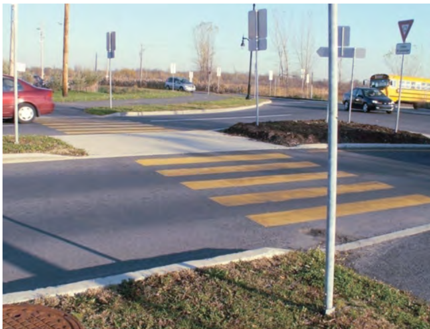
Photo 13 : Îlot séparateur délimité de chaque côté par une bordure de gazon; surfaces avertissantes manquantes à l'entrée et à la sortie de l'îlot ainsi qu'aux emplacements de traversée
