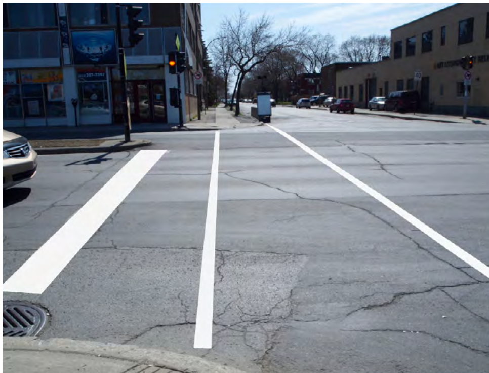
Photo 2a : Terre-plein éloigné du passage pour piétons
